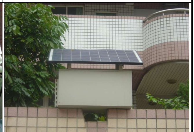
說明：太陽能板儲電供前庭燈照明
