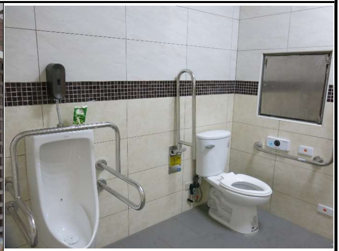
說明：無障礙廁所內部設備完善
