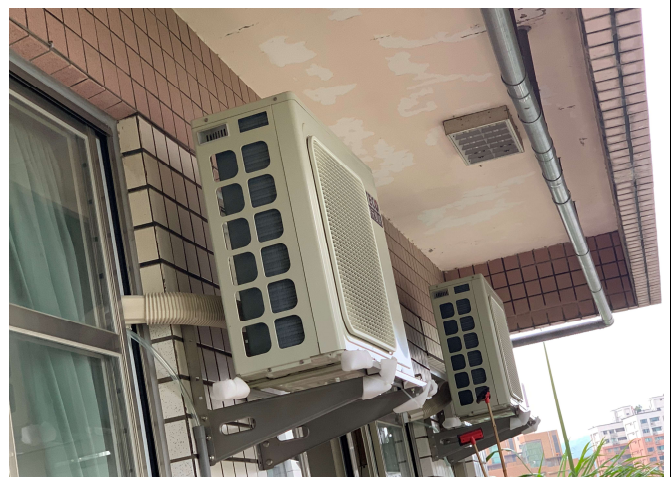
說明：教室外走廊的冷氣室外機
